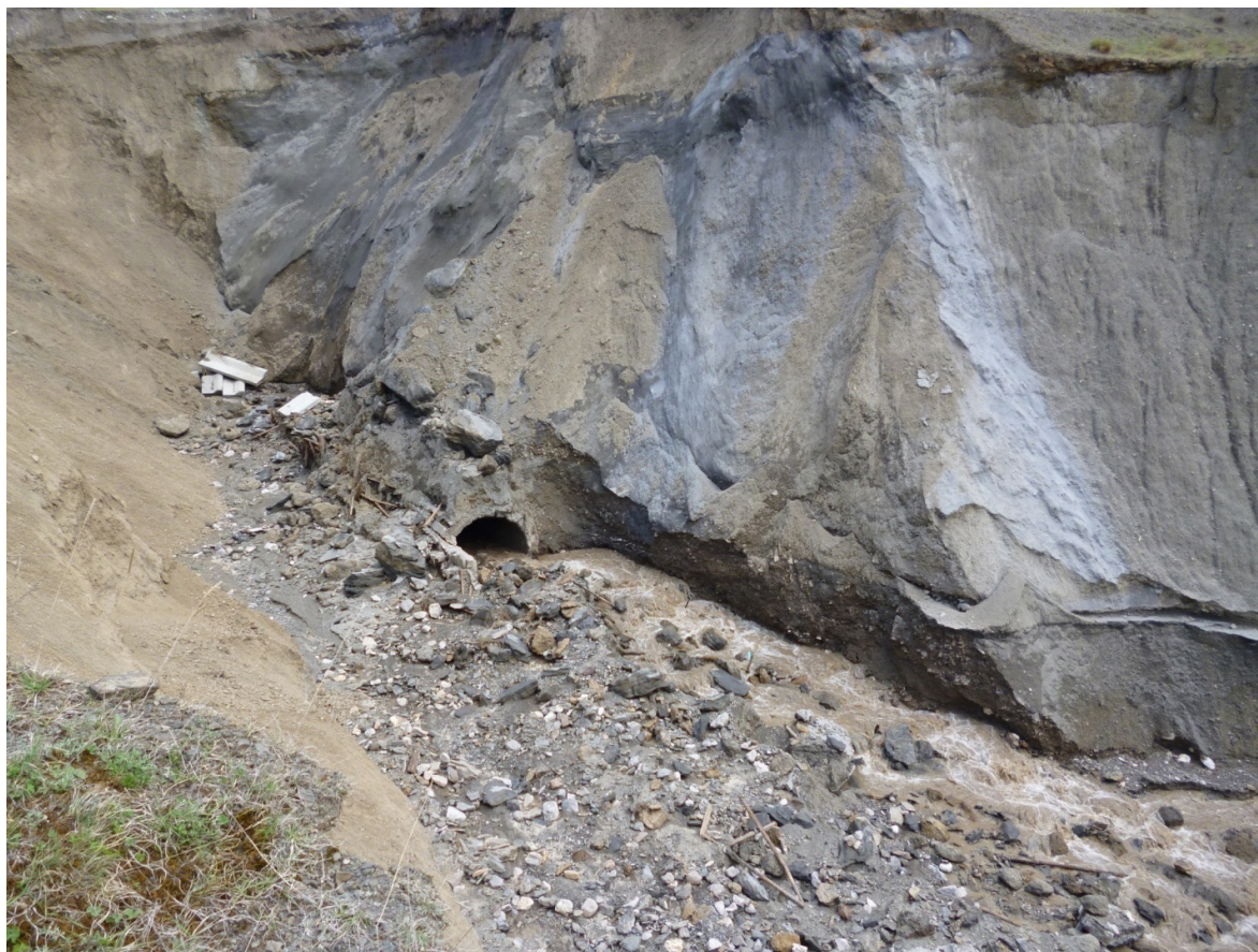
Рис.2. Фрагмент смыва тела Фиэгдонского хвостохранилища в 2011 году.
